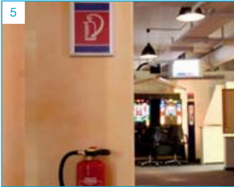
5 Standorte der Feuerlöscher sind gekennzeichnet und die Feuerlöscher sind gut sichtbar angebracht und erreichbar.
