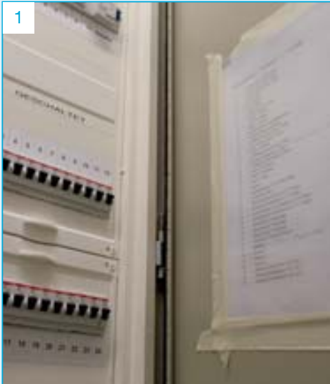
1 Schaltkreise der elektrischen Anlage sind gut lesbar im Sicherungskasten gekennzeichnet.
