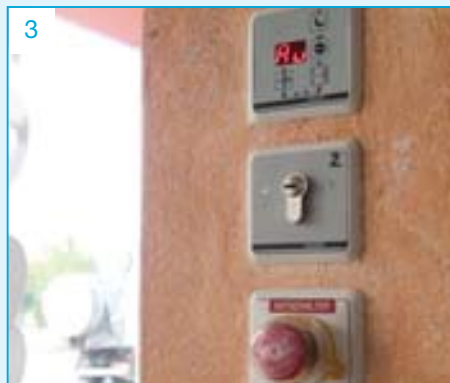
3 Die automatische Tür im Eingangsbereich ist gesichert.
